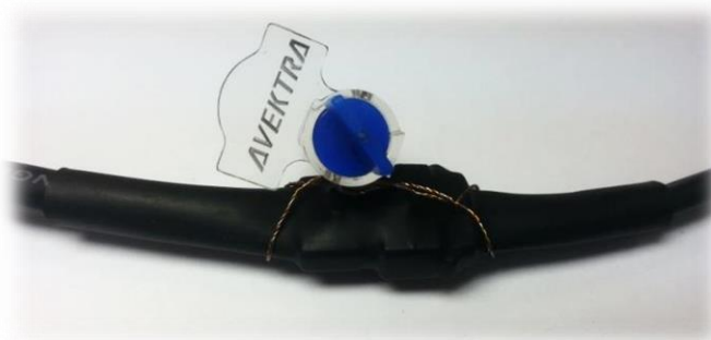
Рисунок 3. Пломба на электрической магистрали проточной части.
